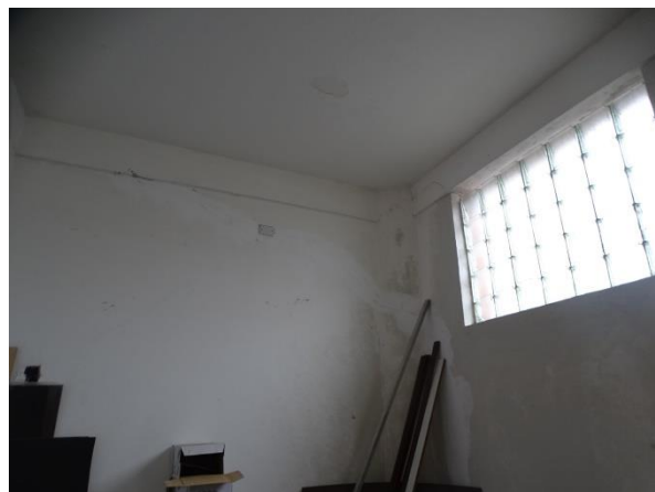
Foto 20 - Vista em detalhe do subsolo do galpão. Observar a presença de fissuras.
