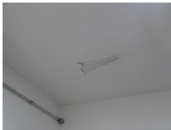
Foto 6 - Vista em detalhe da área administrativa. Observar soltura da pintura.
