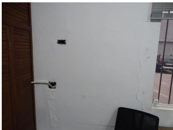
Foto 9 - Vista em detalhe da área administrativa. Observar embolhamento da pintura.
