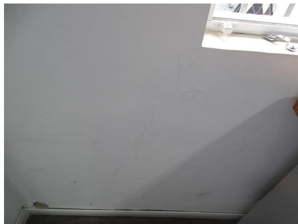
Foto 8 - Vista em detalhe da área administrativa. Observar fissura a partir do vértice da esquadria.
