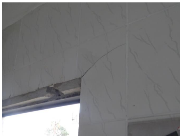
Foto 11 - Vista em detalhe da cozinha. Observar fissura a partir do vértice da esquadria.
